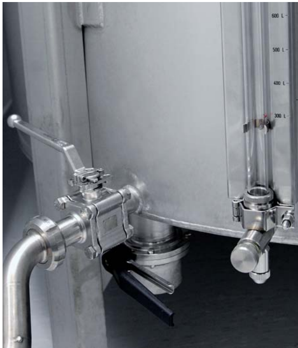
Préparation, mélange, dilution en cuves inox en salle ATEX classée ISO 8
