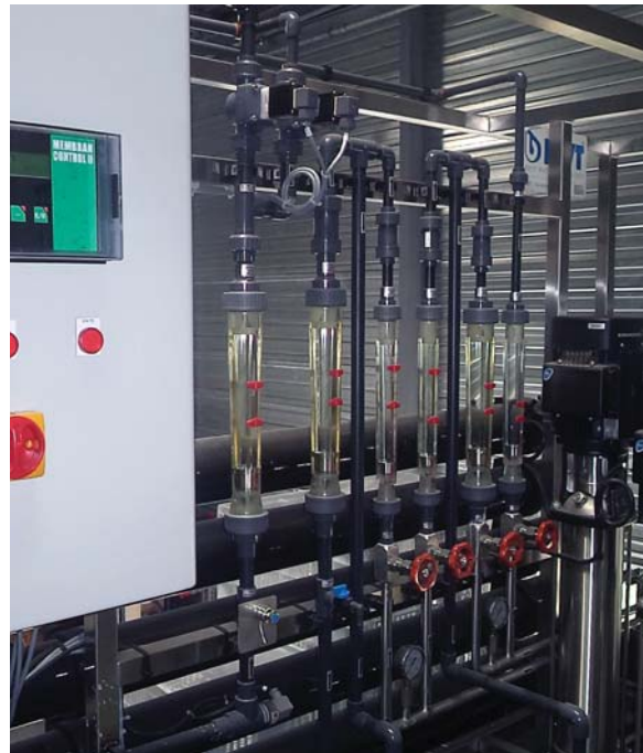
Station d'eau hautement purifiée
